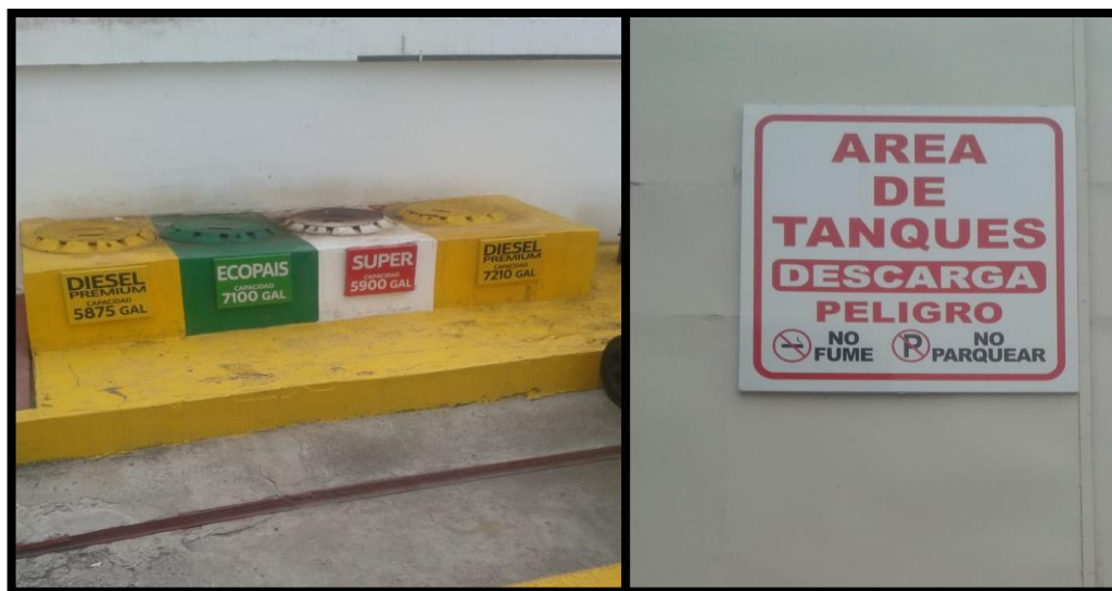
Fig 33. Área de descarga de combustibles – Boca tomas
