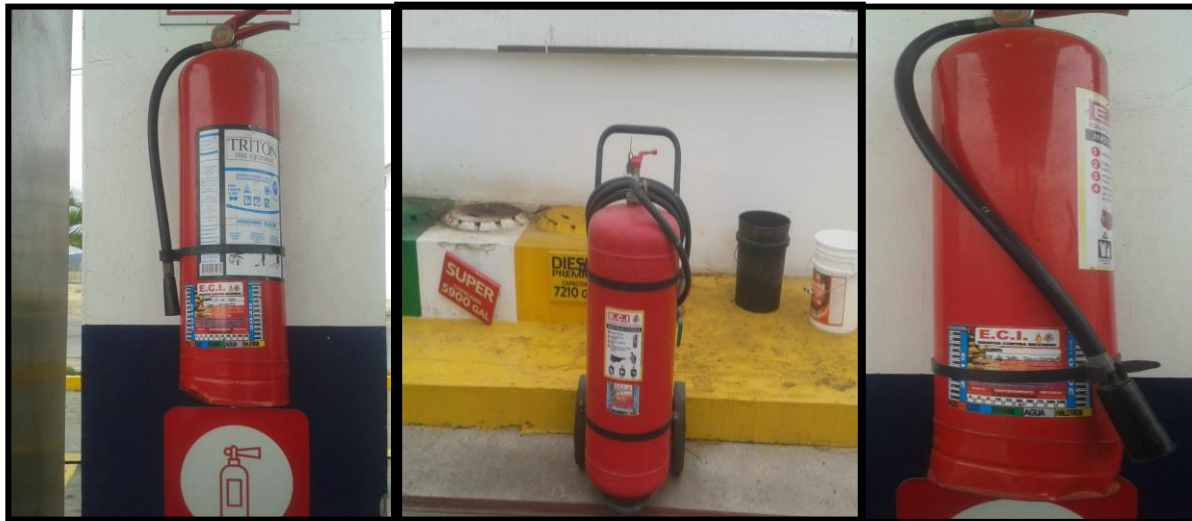
Fig. 40 Sistema contra incendios en la estación. Fuente: Equipo Técnico
