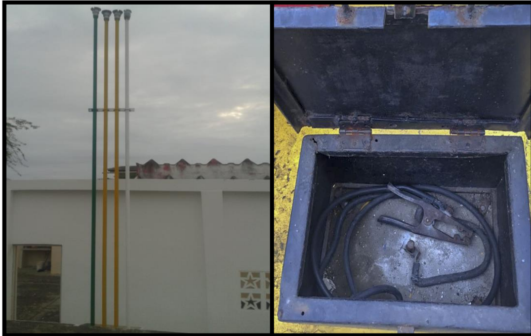
Fig. 36 Izq.: Tubos de venteo; Der: Pinza de conexión a tierra. Fuente: Equipo Técnico
