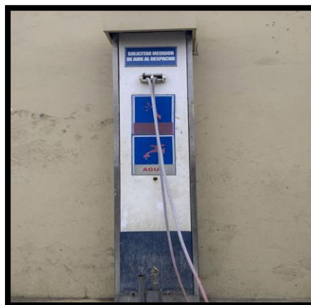
Fig. 41 Servicios complementarios en la estación: servicio de agua y aire
