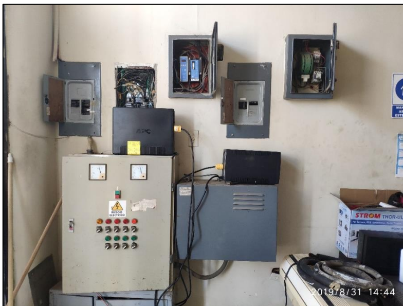
Imagen 11: Tableros de transferencia de energía.
