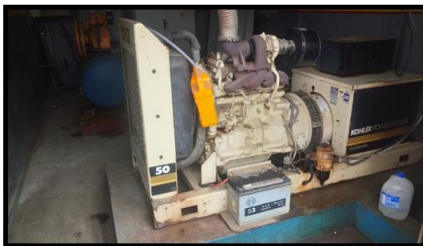
Fig 42. Generador de energía
