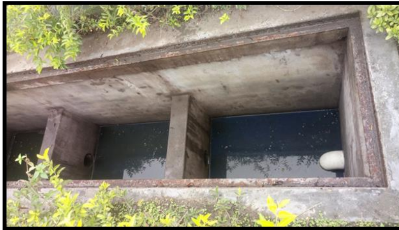
Fig. 33 Trampa de grasa E/S LOS PITS
