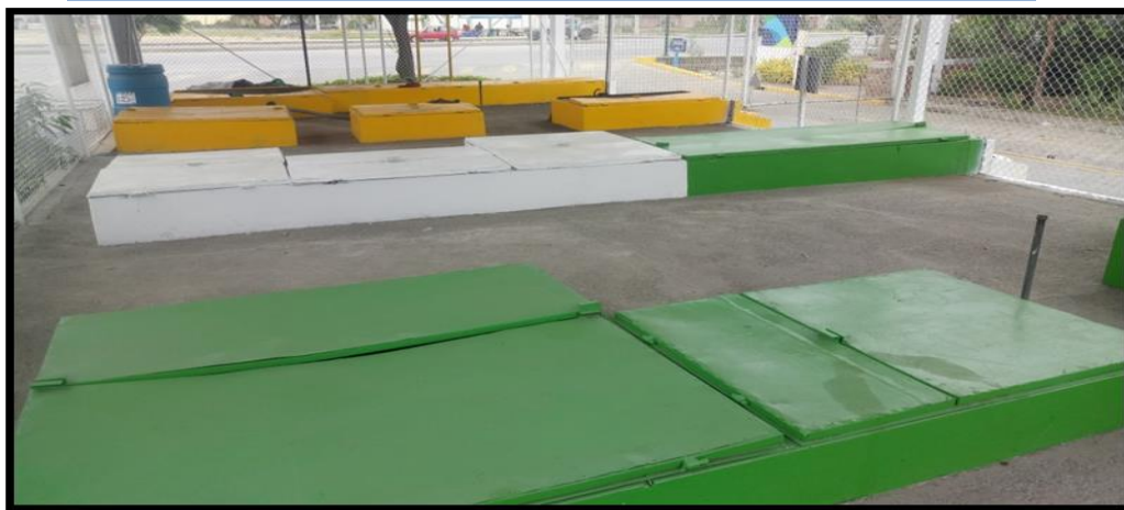
Fig. 34 Tanques subterráneos de almacenamiento de combustible E/S LOS PITS
