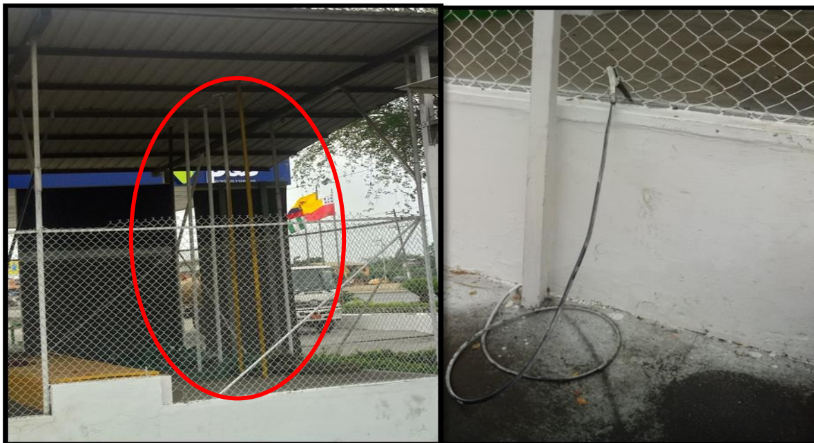
Fig. 35. Izq.: Tubos de venteo; Der: Pinza de conexión a tierra. Fuente: Equipo Técnico
