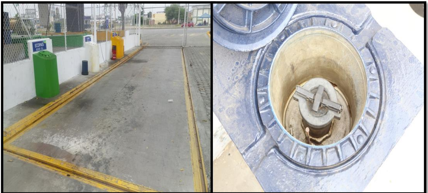
Fig 32. Área de descarga de combustibles – Boca tomas
