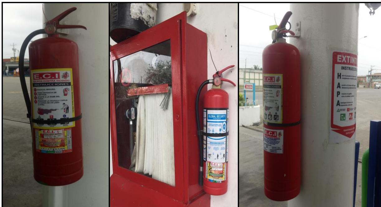
Fig. 39 Sistema contra incendios en la estación. Fuente: Equipo Técnico
