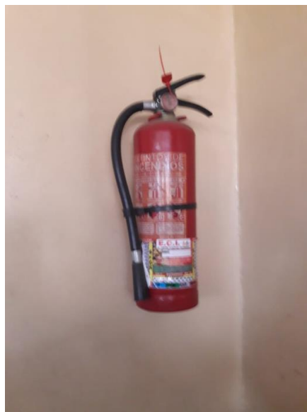
Imagen 11: Extintor del área de cuarto de máquinas.
