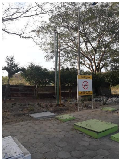
Imagen 4: tubos de venteo.
