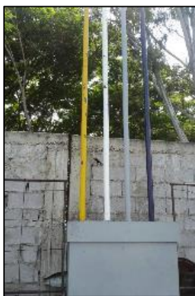
Fotografía 13. Tuberías de venteo
