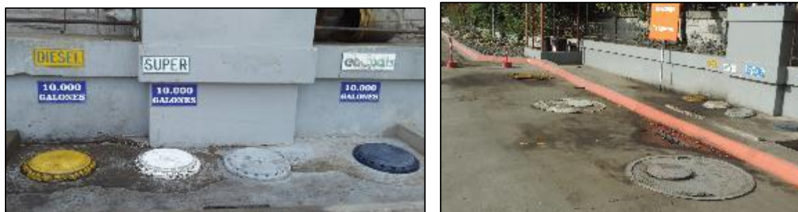
Fotografía 8. Tanques de Almacenamiento y área de descarga
