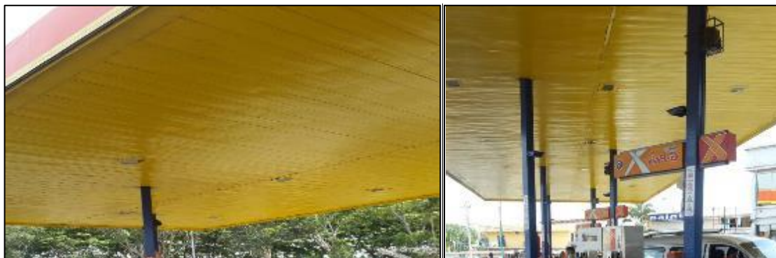
Fotografía 5. Marquesinas y luminarias
