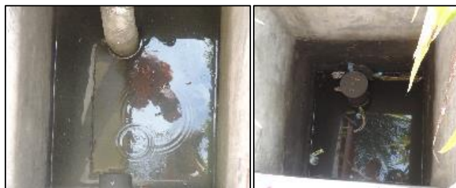
Fotografía 12. Trampas de Grasa, antes, después
