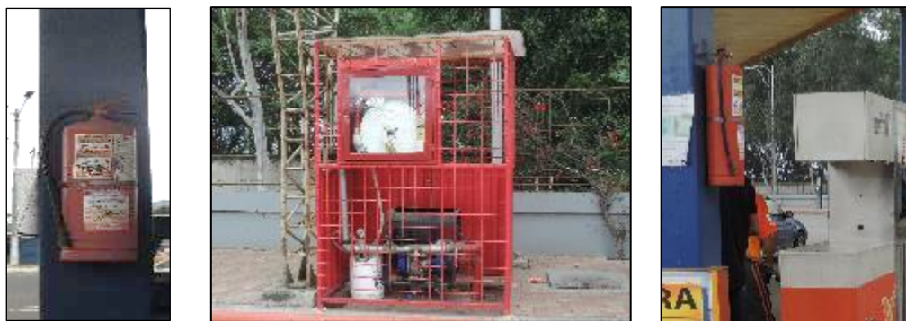
Fotografía 20. Equipo contra incendios
