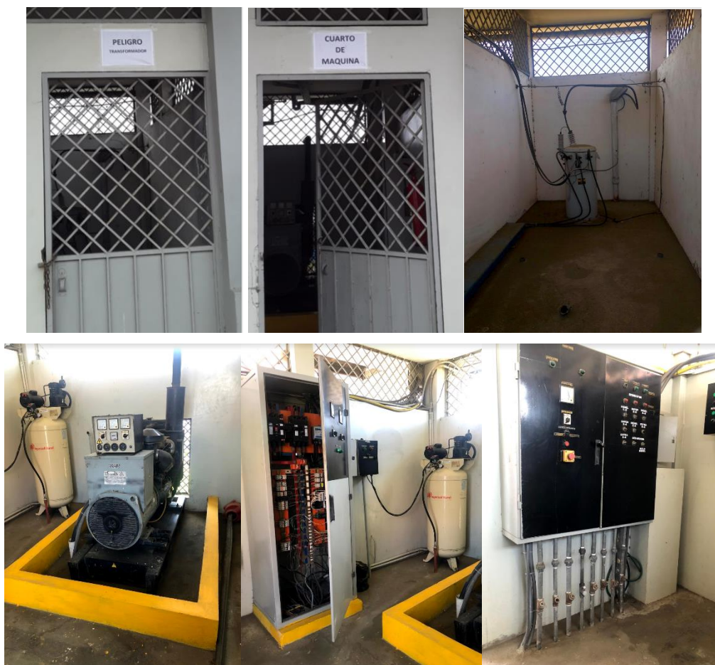
Figura 11. Cuarto de máquinas
