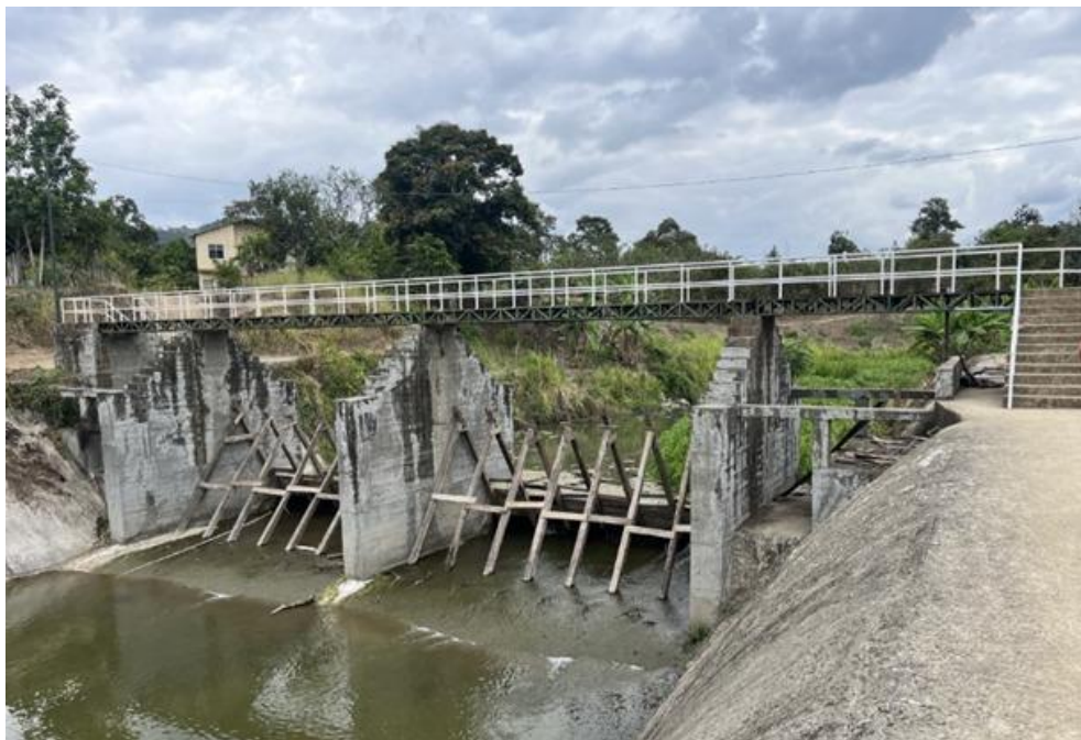
Ilustración 8 Compuerta El Porvenir Fuente: Dirección de Riego y Recursos Hídricos
