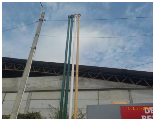
Fotografía 3.- Tubos y válvulas de venteo
