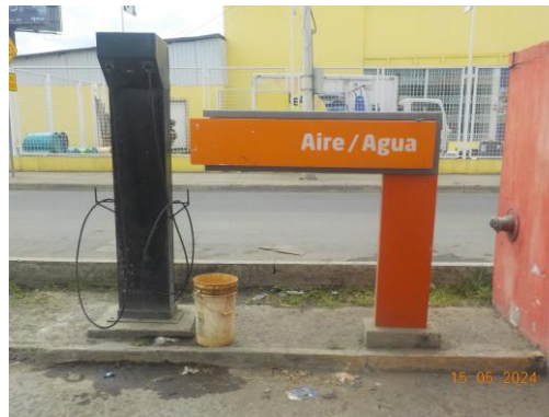
Fotografía 19.- Dispensador de agua y aire.
