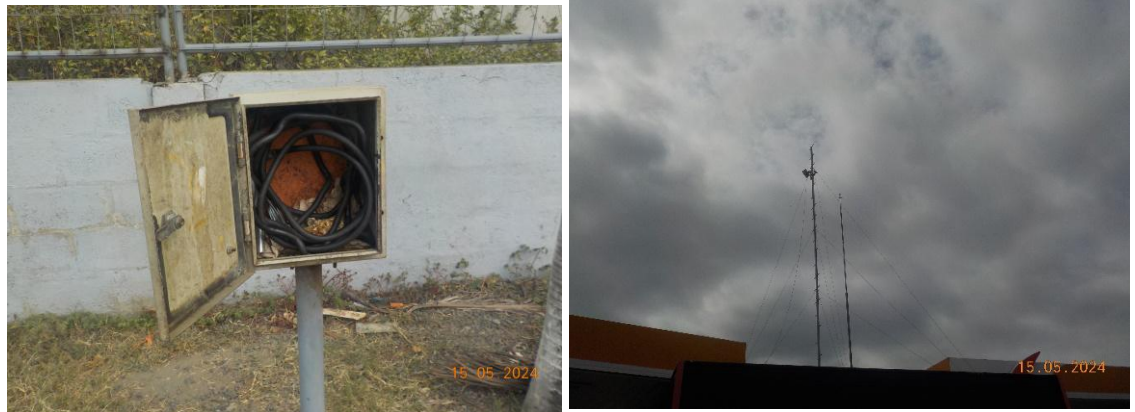
Fotografía 6.- Sistema de puesta a tierra y pararrayo
