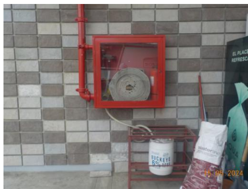
Fotografía 20.- Gabinete contra Incendios.
