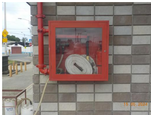
Fotografía 5.- Gabinete contra incendios
