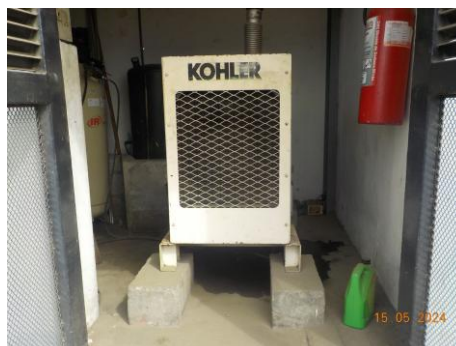
Fotografía 22.- Generador de Emergencia
