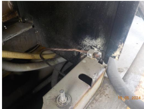
Fotografía 14.- Sistema de conexión a Tierra de surtidores
