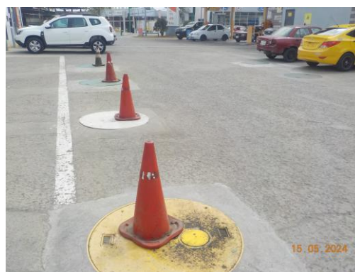
Fotografía 9.- Contención de derrames.
