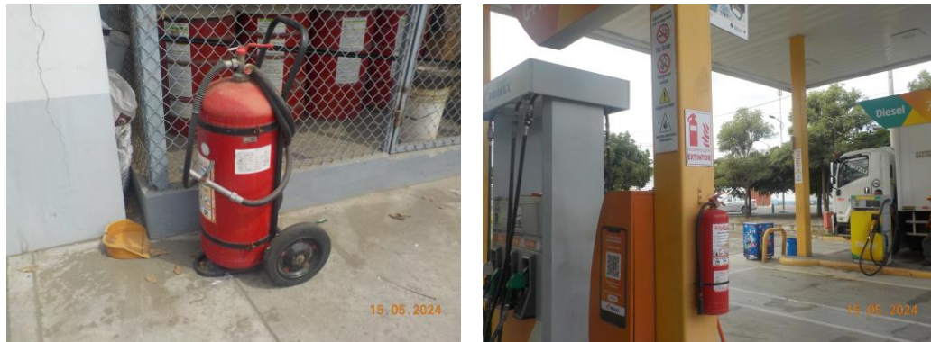
Fotografía 21.- Extintor Móvil y extintor de isla de despacho
