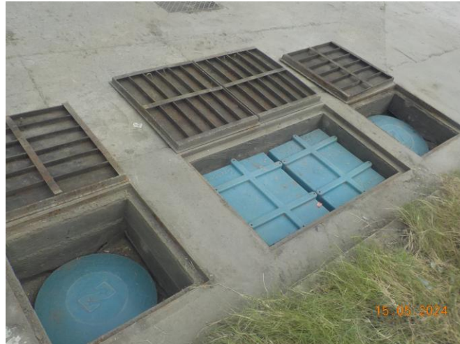
Fotografía 28.- Trampa de grasas
